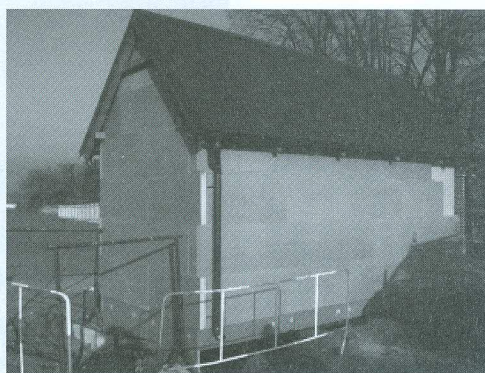
Nadzemní část technologie míchání vody
